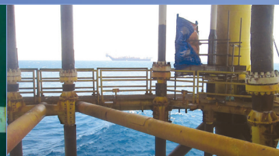
DANO MECÂNICO, TRINCA, AMASSADO, SABOTAGEM
